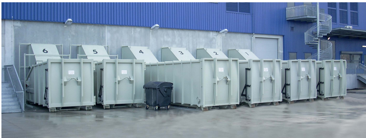
Conteneurs de transport sur une station de compacteurs postes-fixes
