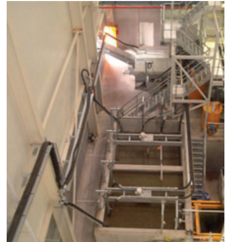
Übersicht Bibko-Anlagentechnik Bereich BLANDE ANLÆG. Oben zu sehen ist das Rührwerksbecken 1, unten das Rührwerksbecken 2
