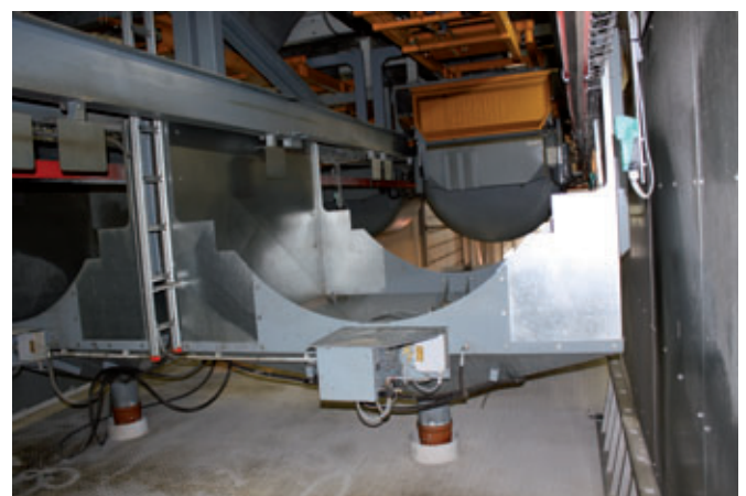
Reinigungsstation für die Kübelbahnen
