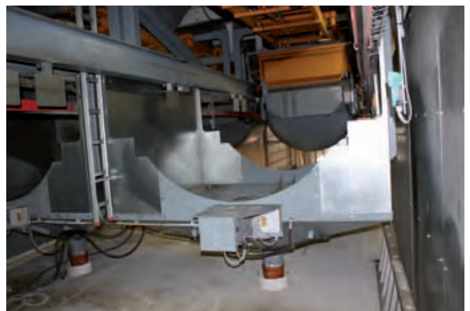
Estación de limpieza para las cubas aéreas
