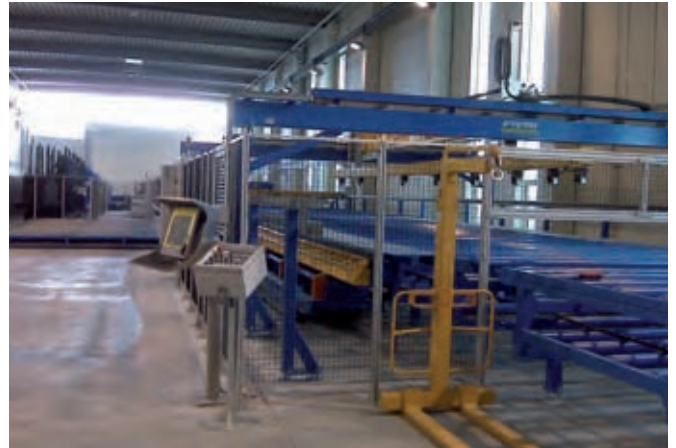
En la instalación de soldado de mallas se pueden producir mallas con dimensiones de hasta 6 x 12 m.
