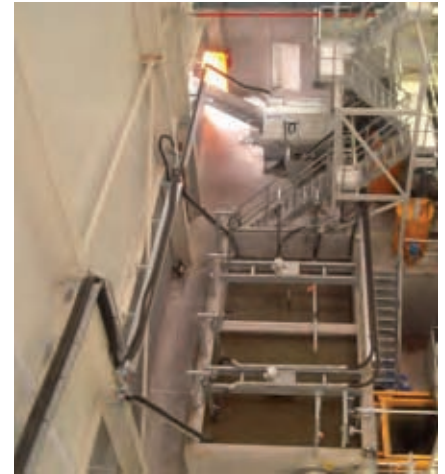
Vista de la técnica de la instalación Bibko, zona BLANDE ANLÆG. En la parte superior puede verse el tanque con agitador 1, en la parte inferior el tanque con agitador 2.
