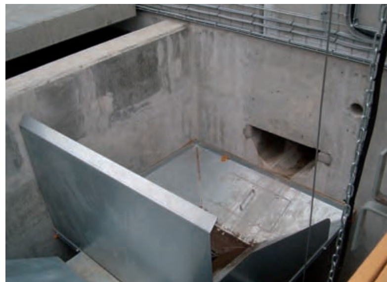
Zona de descarga de la acanaladura a la instalación RWS.
