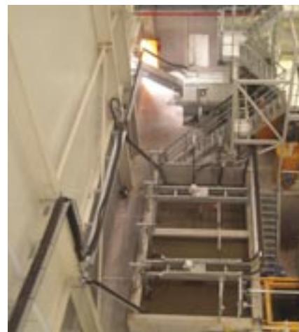
Wygląd obszaru BLANDE ANLÆG systemu recyklingu firmy Bibko. Na górze widoczny jest zbiornik nr 1, na dole zbiornik nr 2.
