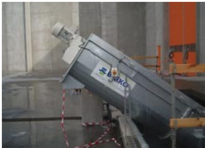
Zsyp systemu RWS (podczas montażu).
