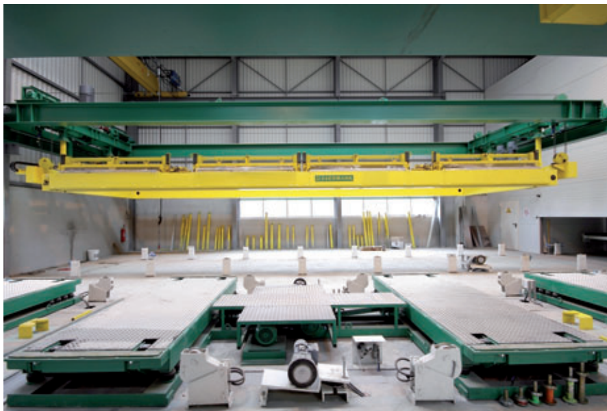
Übersicht Verdichtungsstation und Wendeautomat
