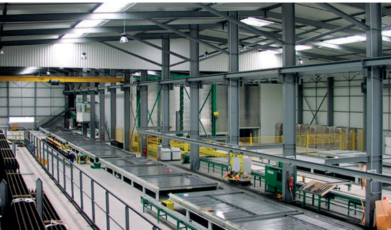
Instalación a carrusel
