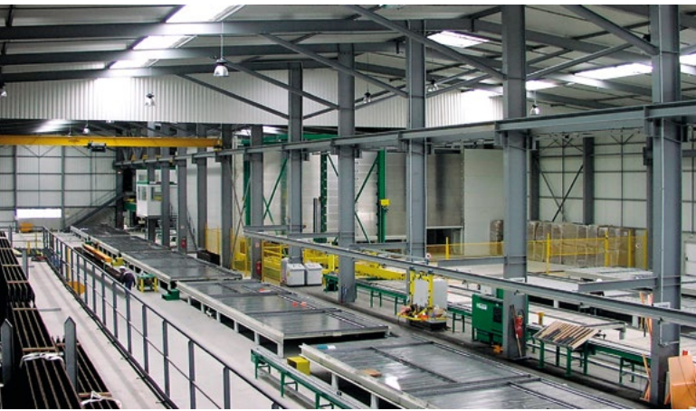
Installation à circuit de palettes
