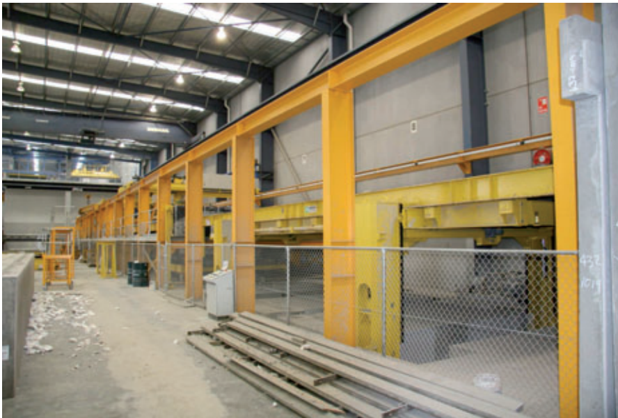
Vorhärtetunnel und Glättstationen
