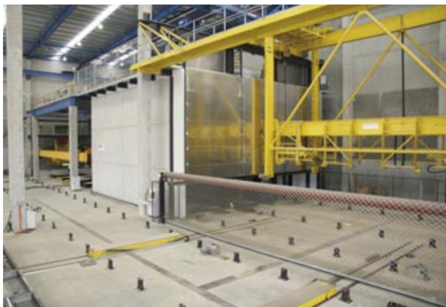
Komora dojrzewania wraz z urządzeniem obsługującym regaty.
