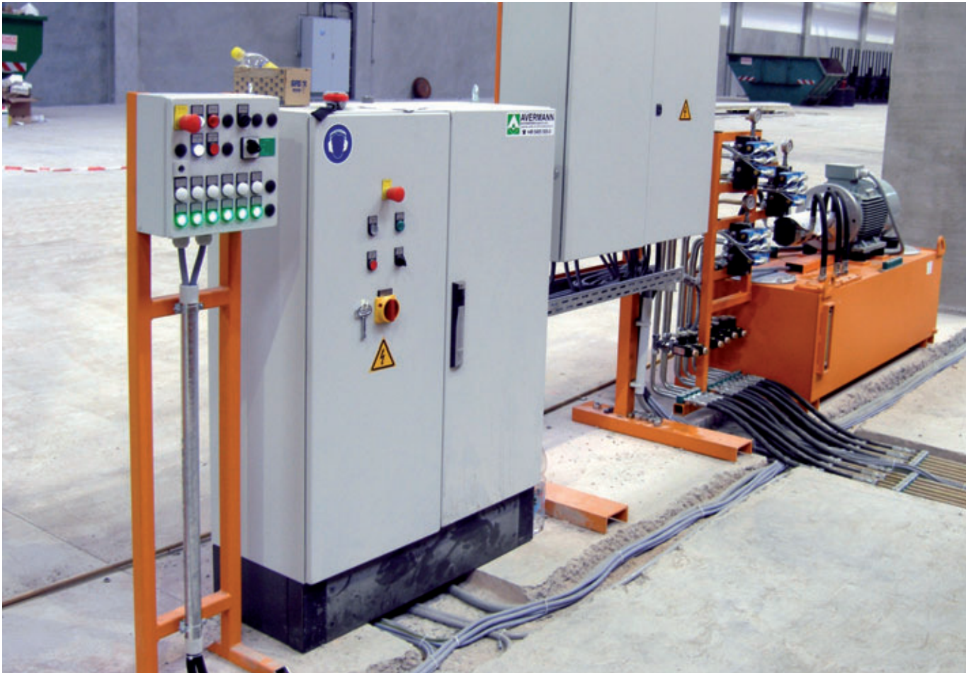
Poste de commande avec commande hydraulique et de vibration
