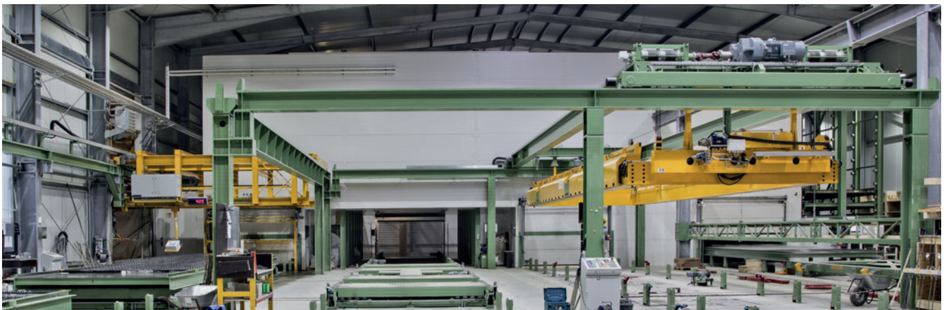
Schwingverdichter unter der Betonierstation und unter dem Wendeautomaten
