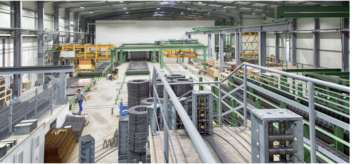
Instalación a circulación área de hormigonado/compactación, volteado y estación de elevación
