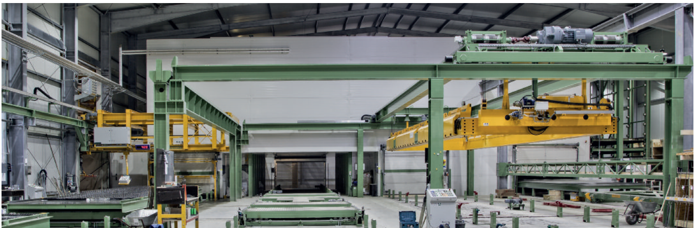
Jednostka zagęszczania poprzez wibrowanie pod stanowiskiem betonowania i pod automatem do odwracania elementów.
