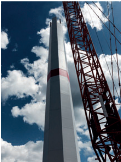
Tour hybride Ventur brevetée pour centrales éoliennes
