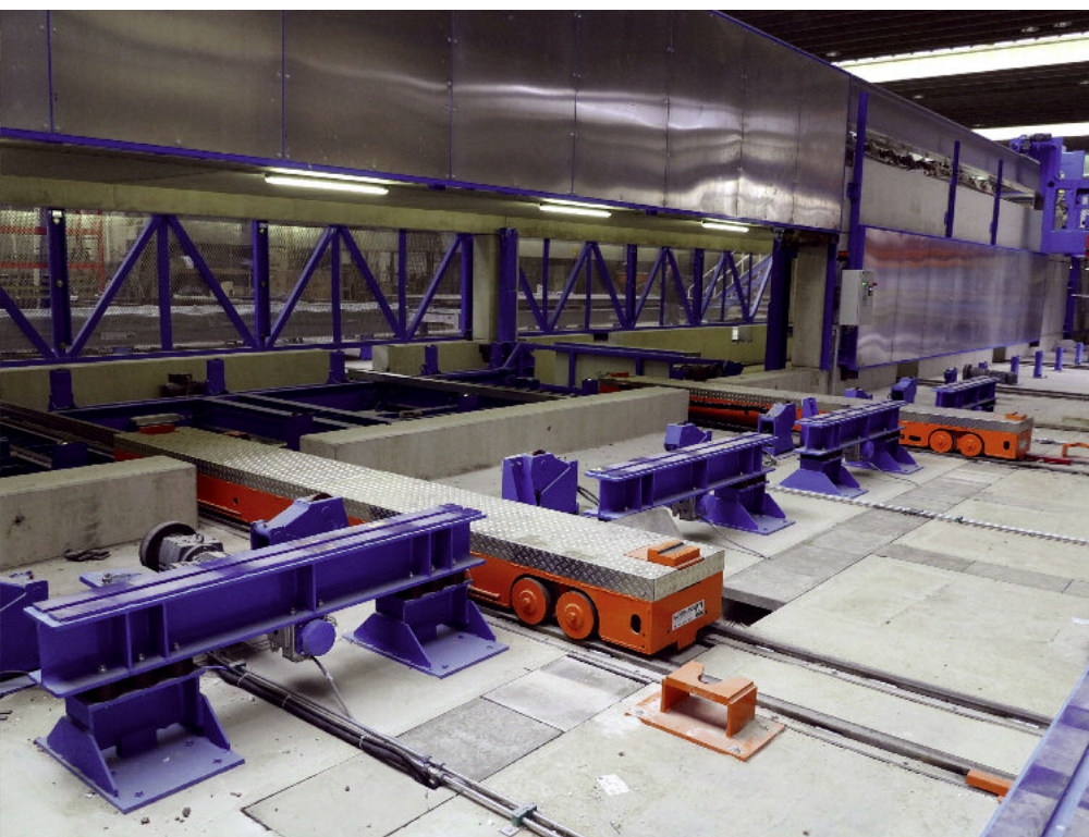
Centralna przesuwnica z poprzecznym wózkiem podnośnikowym podczas wjazdu na stanowisko zagęszczania.
